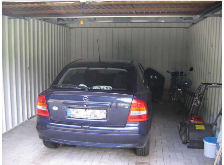
Wasser versickert zwischen den Verbundpflastersteinen
